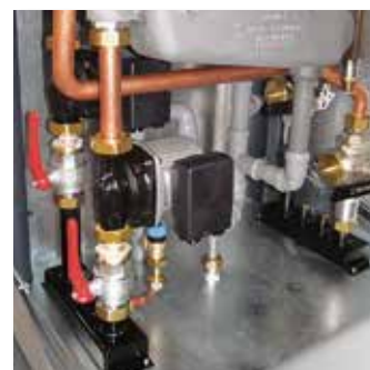
Szivattyúk és elzárók
